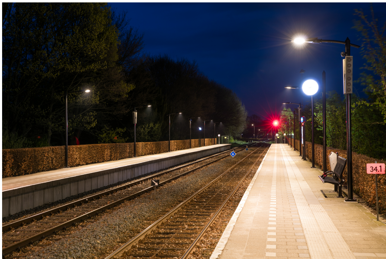
Foto: LED-verlichting met aanwezigheidsdetectie station Lichtenvoorde - Groenlo.
