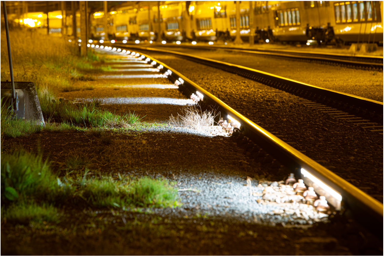
Foto: Spoorstaafverlichting emplacement Lelystad.
